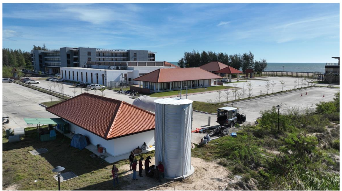
ตชด.ภาค 6 RCT-15-57 (40,173 ลิตร) อ.ชะอำ จ.เพชรบุรี เส้นผ่าศูนย์กลาง 2.995 H: 5.7 m สำหรับน้ำใช้ในรีสอร์ท สำหรับ 80 ห้อง ในศูนย์ฝึกอบรมพัฒนา บุคลากรและสวัสดิการสำนักงานตำรวจแห่งชาติ อ.ชะอำ จ.เพชรบุรี
