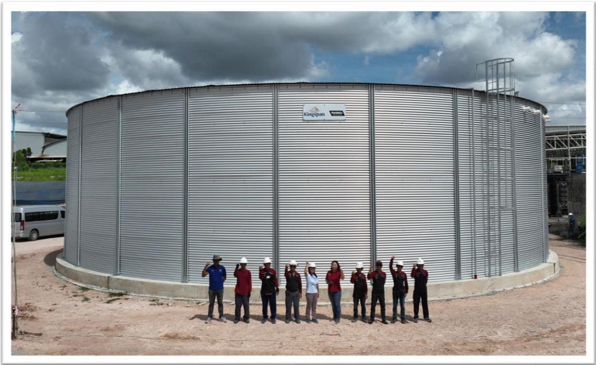
WHA ถังน้ำคิงสแปนโรโน รุ่น RCT940-64 (2,731,133 ลิตร) ปลวกแดง จ.ระยอง เส้นผ่าศูนย์กลาง 12.623m H: 5.7m สำหรับน้ำ UF และ RCT940-64 (2,731,133 L) Dia: 23.305m H: 6.4m สำหรับน้ำ RO เพื่อใช้สำหรับโรงงานผลิตโซลาร์เซลล์
