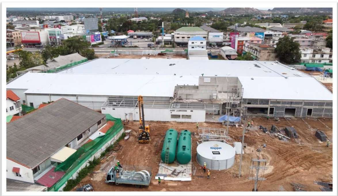
โลตัส RCT-100-22 (104,250 ลิตร) อ.ชะอำ จ.เพชรบุรี เส้นผ่าศูนย์กลาง 7.768 m H: 2.2m. ติดตั้งที่โลตัส อ.ชะอำ จ.เพชรบุรี ใช้สำหรับน้ำดื่มสะอาด และถัง ดับเพลิง
