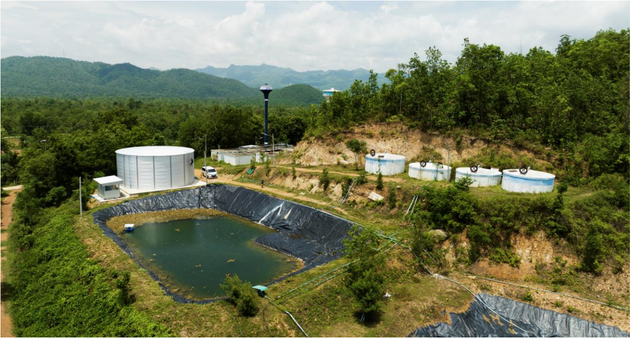
RCT-360-64 (1,058,423 ลิตร) ต.หนองเป็ด จ.กาญจนบุรี ปรับปรุงระบบประปาเดิม
