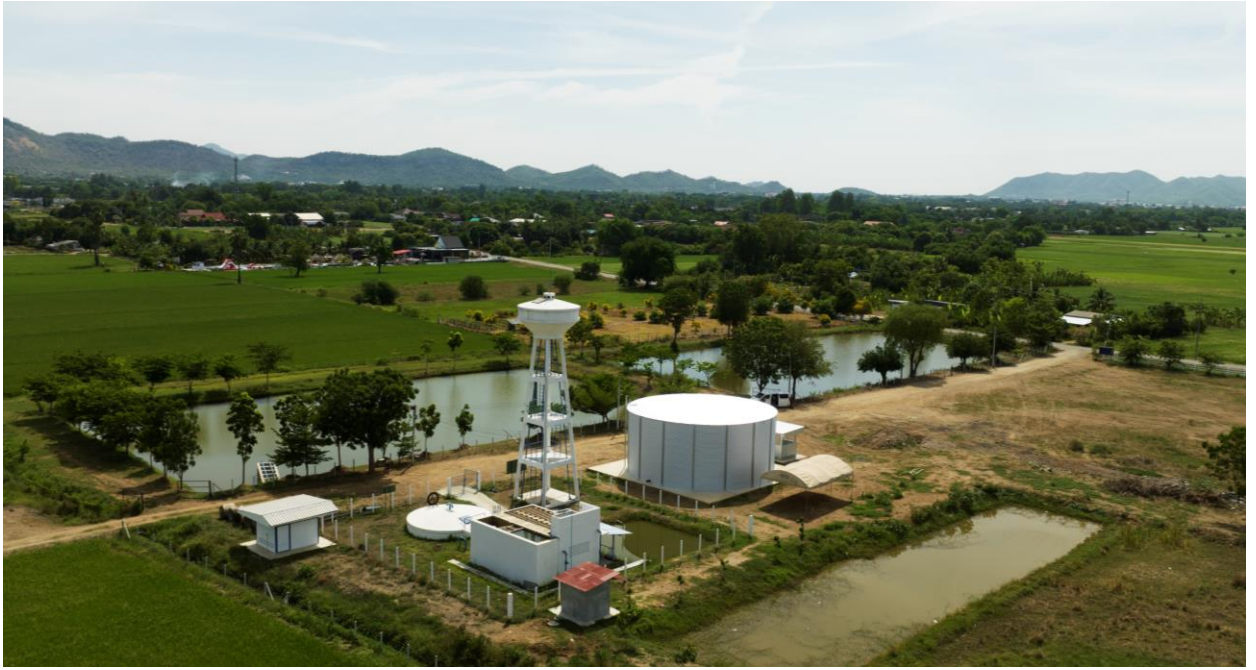
RCT-360-64 (1,058,423 ลิตร) ต.ท่ามะขาม จ.กาญจนบุรี ปรับปรุงระบบประปาเดิม
