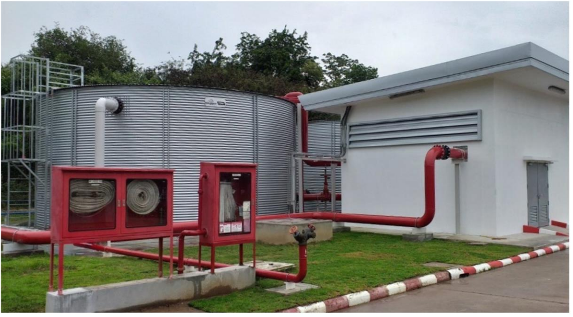
INVE รุ่น RCT-160-43 (318,376 ลิตร) เขาใหญ่ จ.นครราชสีมา เส้นผ่าศูนย์กลาง 9.710 ม. สูง 4.30 ม. ถังเก็บน้ำดับเพลิงจำนวน 2 ใบ เพื่อใช้สำหรับความปลอดภัยใน โรงงาน อ.วชิรบุรี จ.พิจิตร
